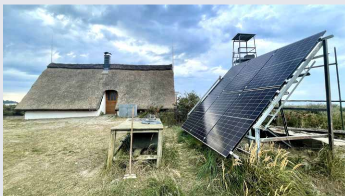
Sechs Solarmodule sorgen für ausreichend Strom für die Vogelwärter. Fotos: LPV Dummerdorfer Ufer e. V.
