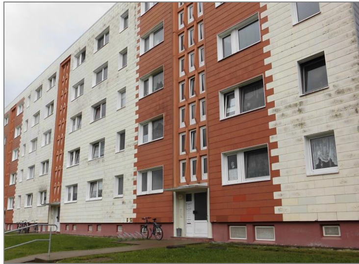
Abbildung 36: Blockbebauung mit schmutzigen Fassaden
